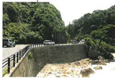
崩落の危険にさらされている西脇道路
