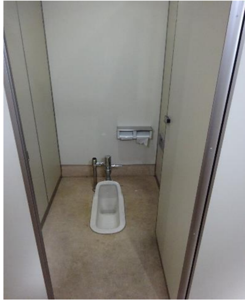
管理教室棟3階南女子トイレ×2
