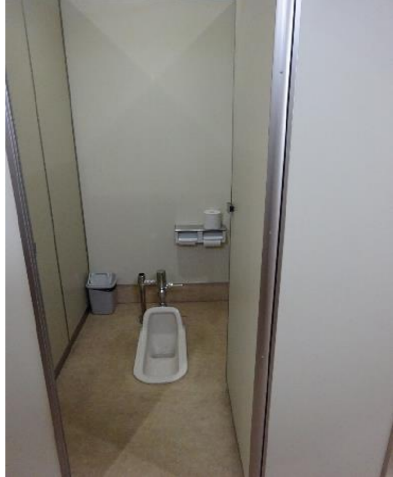
管理教室棟2階南女子トイレ×2
