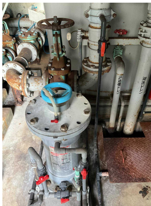
付属機器 (塩素連続注入器)
