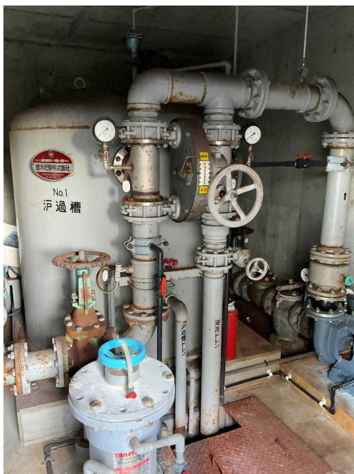
ろ過槽 No.1 系統
