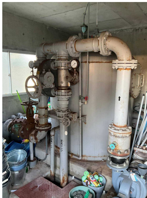
ろ過槽 No.2 系統
