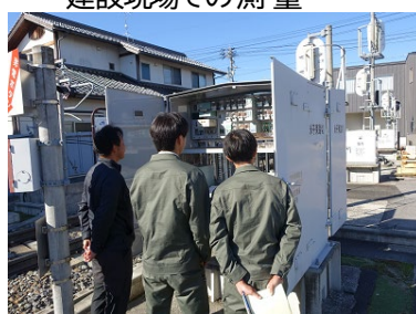
鉄道の電気設備の確認
